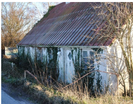
25. Nedslidt. Huller i tag og ingen varme
