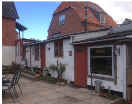
22. Omfattende nedbrydning (skader i tag, råd i vægge).
