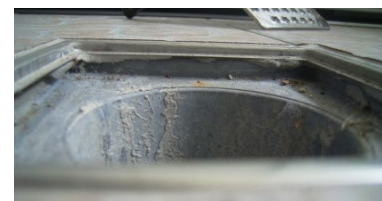
"Ingen skade", Limrester fra montering af fliser og ramme
