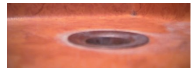
"Rød" Forkert gulv afløb i vinylbelægning.
