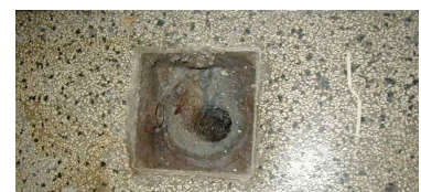
"Ingen skade", Gulv afløb i ældre terrazzogulv. Selv om det er rustent, kan det givet holde i mange år endnu.
