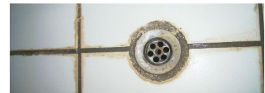
Lille afløb i bruseniche, hvorfra afløbsrøret er ført ind i et andet, større gulv afløb med vandlås.
