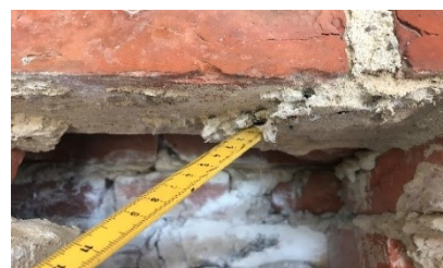
Murbier har gnavet sig langt ind i mørtelfugerne.
