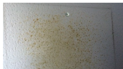
Fugtskade og skimmelvækst bag billede på ydemur med angreb af murbier.
