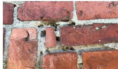
Huller i fuger efter murbier.
