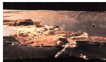
Skader i træværk efter husbuk (huller = 6-10 mm og aflange) (Foto: træinfo.dk).
