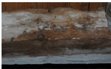
Huller i træværk (spærtræ) efter borebiller (huller = 2-4 mm og runde).
