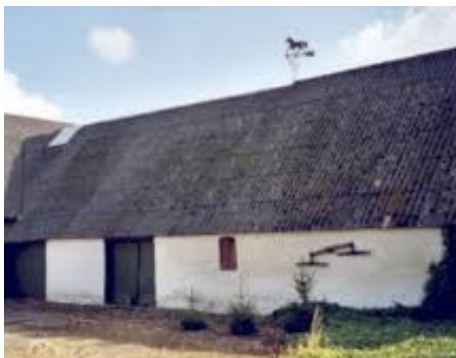
23. Ingen stabilitet og uden restværdi (risiko for kollaps af hvælvinger, revner i vægge)
