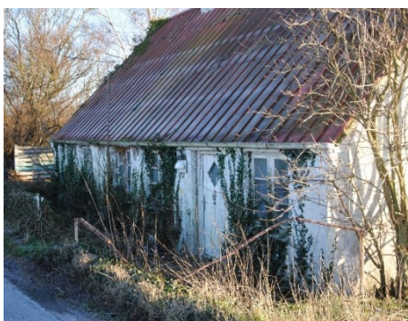
25. Nedslidt. Huller i tag og ingen varme
