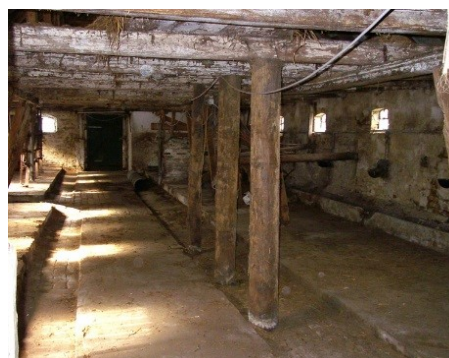
26. Råd og insektskader (gl. indretning med uens gulve)
