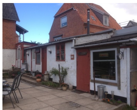
22. Omfattende nedbrydning (skader i tag, råd i vægge).
