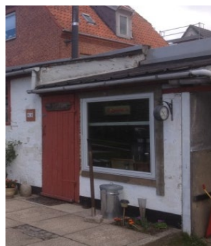
24. Omfattende nedbrydning (skader i tag, råd i vægge).
