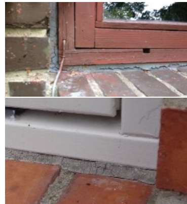
To eksempler på elastiske fuger, som ikke er tætte.
