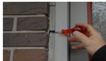
Mørtelfuge, som er revnet ind mod træ og murværk, så den er løs. Der er ikke egentlig risiko for fugt, kun for, at fugen falder ud.
