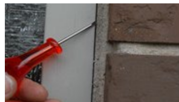
Mørtelfuge, med normal revne mod træ.
